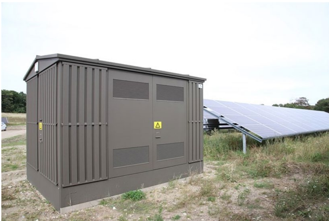
Figur 3-5 Eksempel på en teknikbygning. Her en typisk transformerkiosk. Der etableres ca. én transformerkiosk per 3-4 MW installeret solcellekapacitet.
