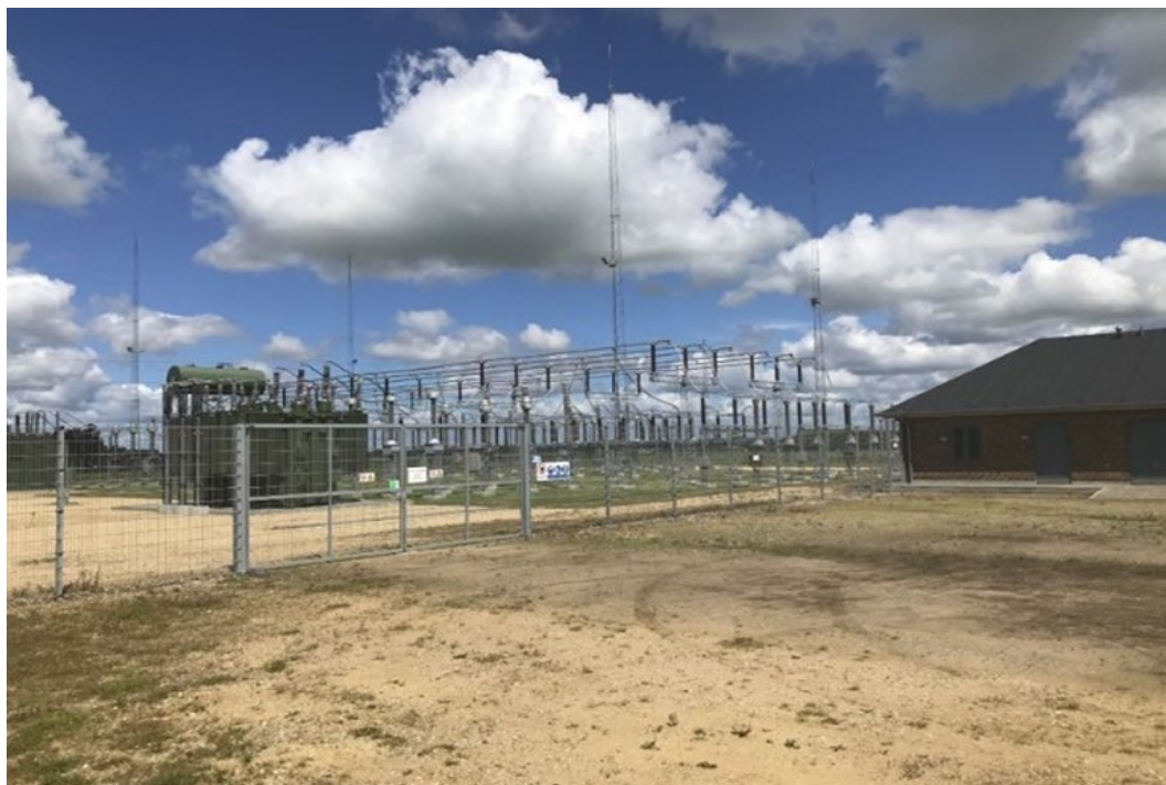
Figur 3-7 Eksempel på en transformerstation med effekttransformer tv. og tilhørende udendørs konstruktioner.
