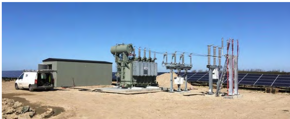
Figur 1-6 Eksempel på stepup-transformer og teknikbygning.
